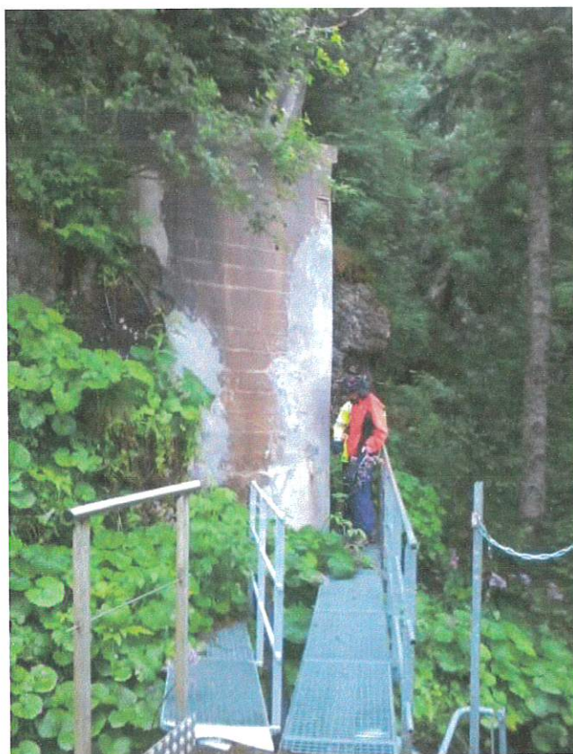
CAPTAGE ROCHER BLANC 2 (Sud)
