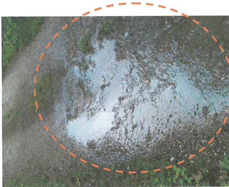
FUITE DU RESEAU D'EAUX USEES SUR LE CHEMIN ROUAST (Périmètre de protection éloignée)
