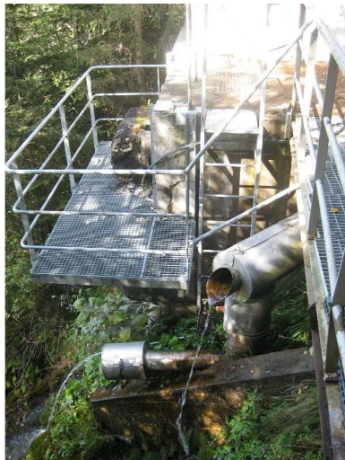
Trop plein + départ Vaulnaveys-le-Haut
