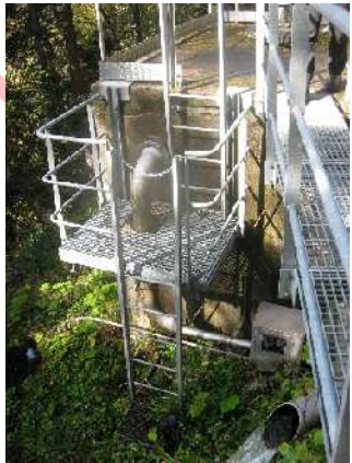
Trop plein bache
