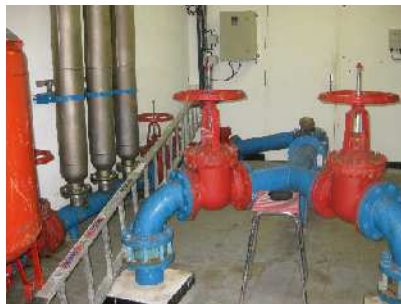
Chambre de vannes
