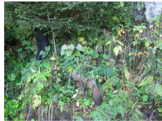
Arrivée d'eau griffon supérieur
