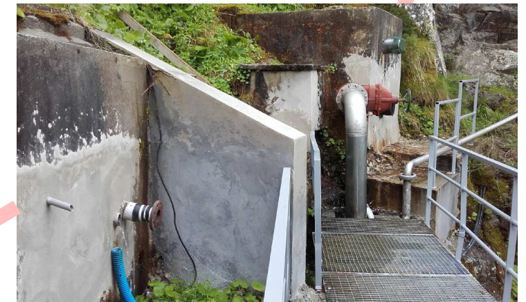
Vue du captage
