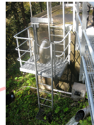
Débitmètre sur trop plein
